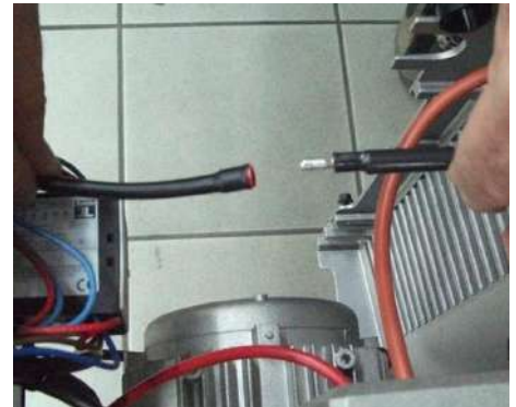
15) Подсоединить кабель электрода ионизации к разъему;
